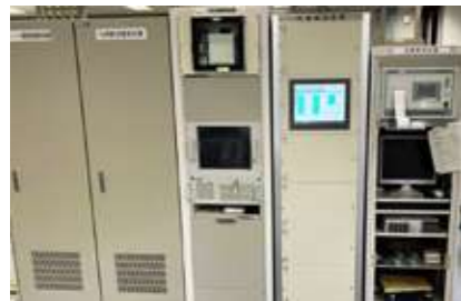
■ 静岡県営ダム遠方監視装置工事
