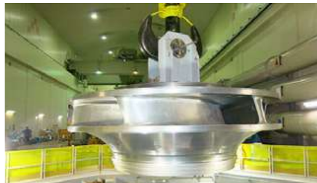
■ 奥美濃発電所水車発電機細密点検
