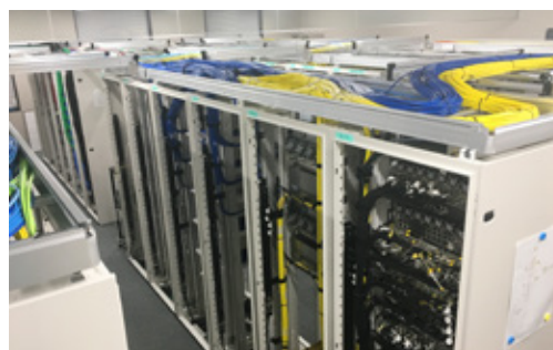
■ CATVセンター設備設置工事
