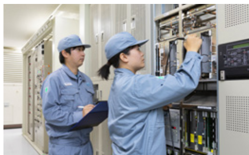
■ 多重無線設備の点検・保守
