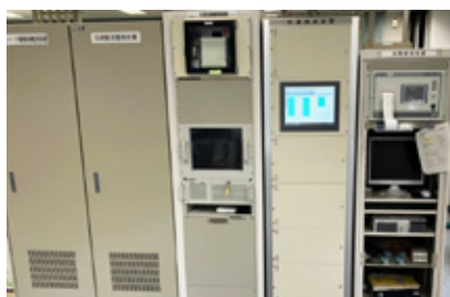
■ 静岡県営ダム遠方監視装置工事
