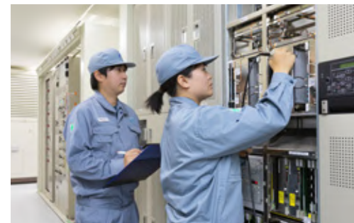
■ 多重無線設備の点検・保守
