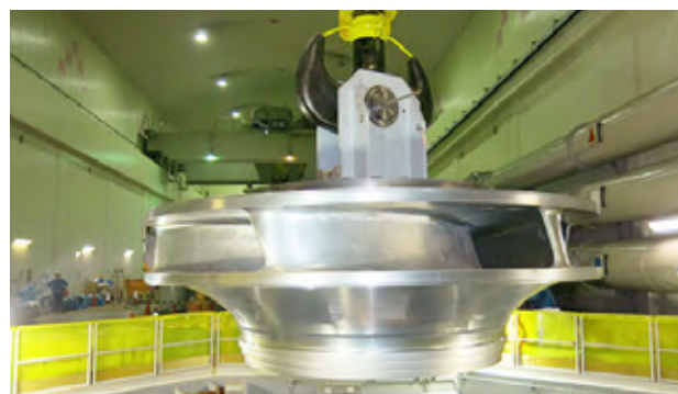
■ 奥美濃発電所水車発電機細密点検
