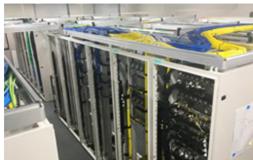
■ CATVセンター設備設置工事
