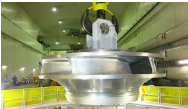
■ 奥美濃発電所水車発電機細密点検
