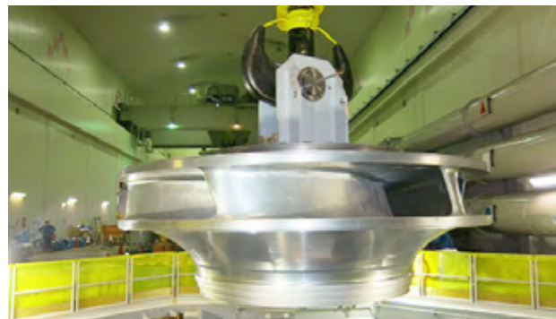
■ 奥美濃発電所水車発電機細密点検
