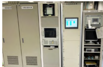
■ 静岡県営ダム遠方監視装置工事
