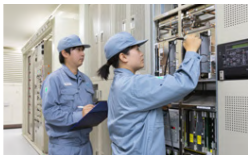
■ 多重無線設備の点検・保守
