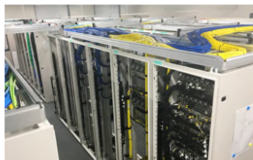
■ CATVセンター設備設置工事
