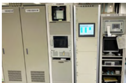
■ 静岡県営ダム遠方監視装置工事
