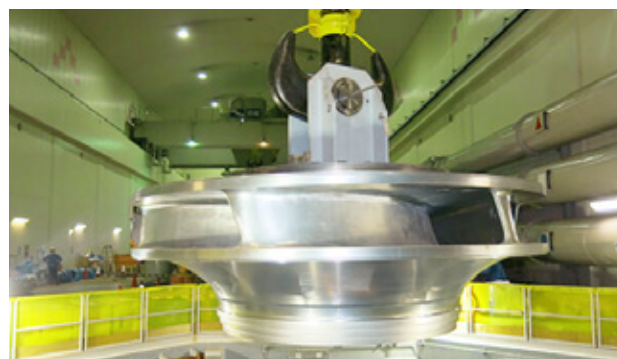
■ 奥美濃発電所水車発電機細密点検
