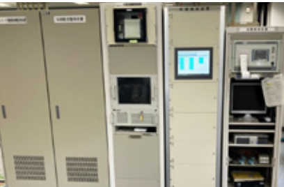
静岡県営ダム遠方監視装置工事
