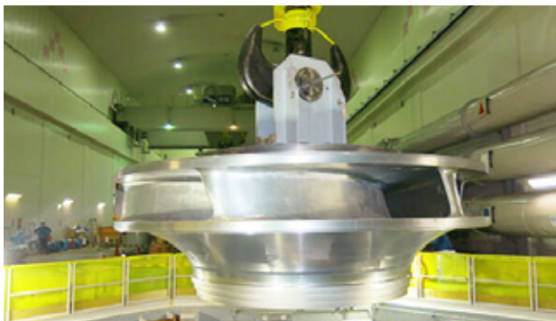
■ 奥美濃発電所水車発電機細密点検
