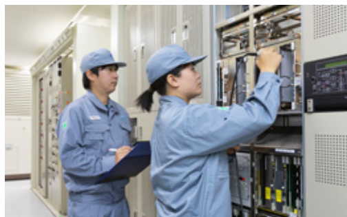
■ 多重無線設備の点検・保守
